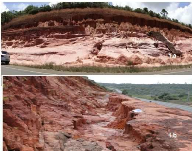
Figura 1. a – Foto panorâmica do afloramento A . b – Local onde se encontrava a canaleta da contenção aplicada.
